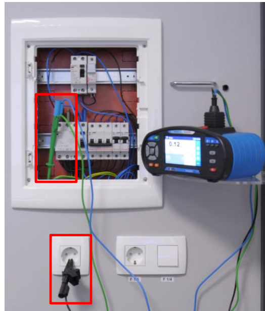
Abbildung 2-43: Durchgangsprüfung zwischen Verteiler und Steckdose
