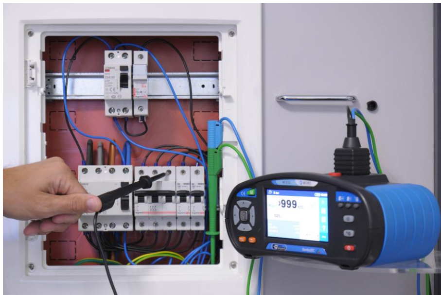
Abbildung 2-33: Isolationswiderstandsmessung am Verteiler - alle Stromkreise eingeschaltet
