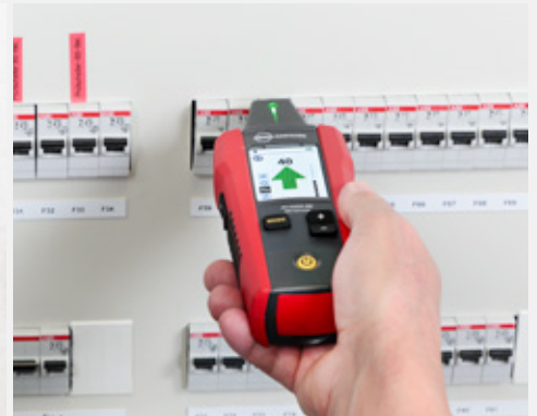
Zuordnung des richtigen Leitungsschutzschalters/Sicherung
