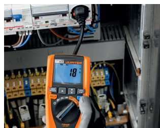
Impedanzmessung ohne RCD-Auslösung
