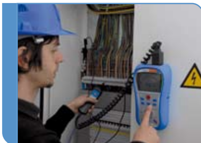
Isolationsmessung an Schaltschränken.
